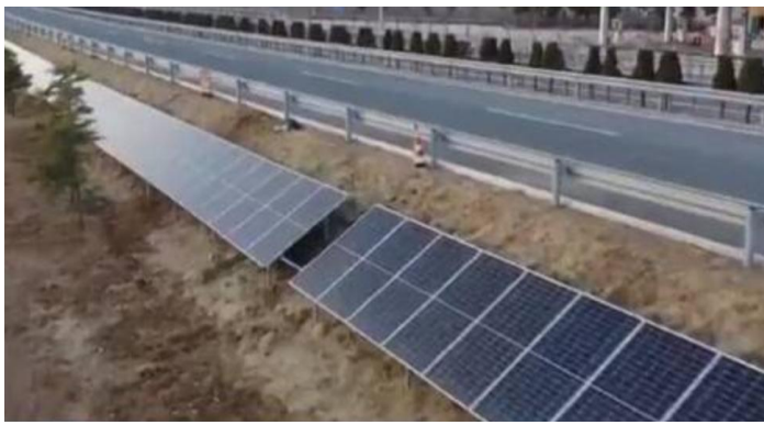
图表 1: 荣乌高速威海段边坡光伏发电试验项目
