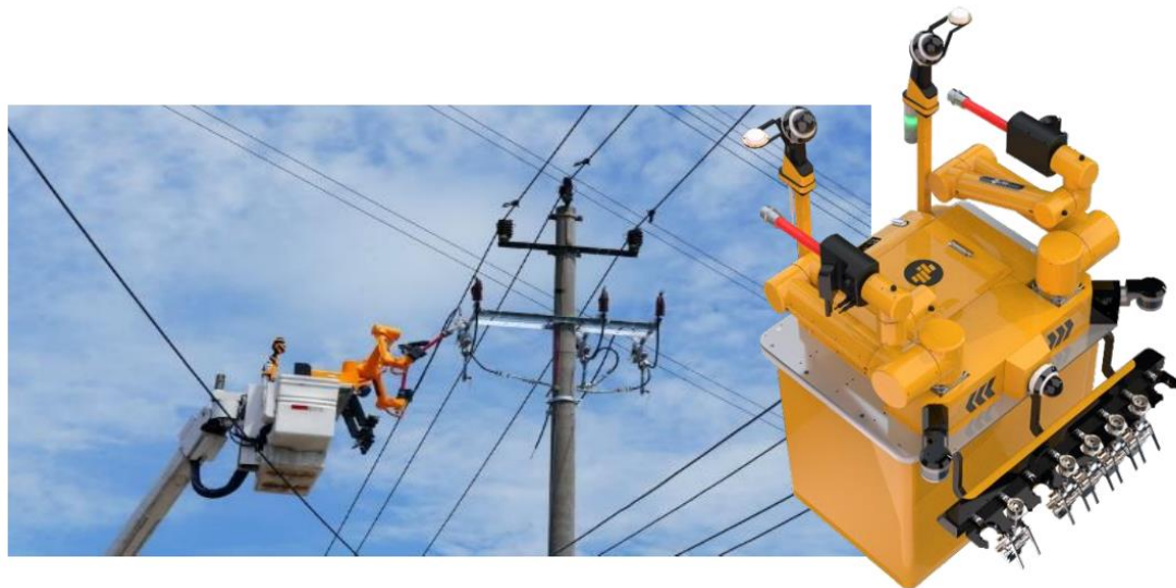
室外带电作业机器人
