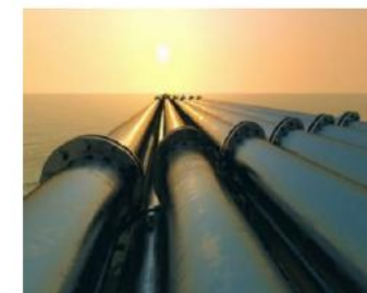
(c) 输油管道
