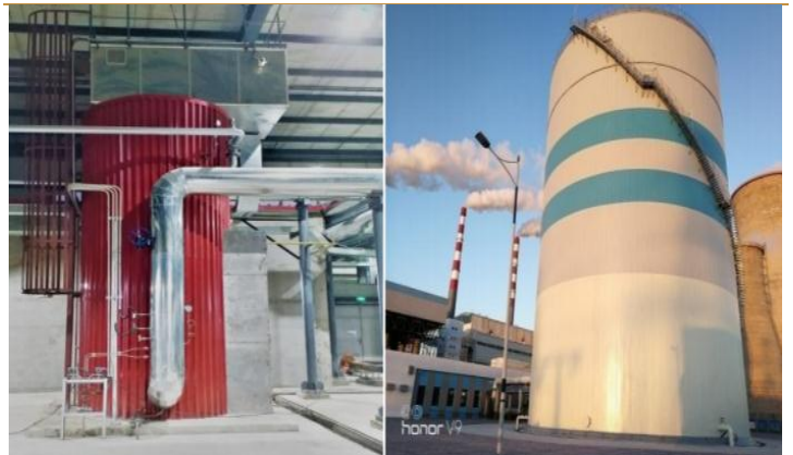
图 41：清洁能源消纳系统实物图
