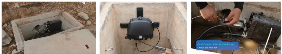
图 5-7 室外管道应用场景
