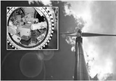
图51：风电机组中的风机变桨系统
