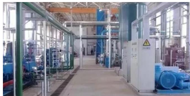
图：国内首套超临界压缩空气储能系统（2013年）
