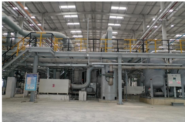
图：金通灵与中科院合作的贵州毕节10MW压缩空气储能项目
