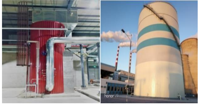
图30：清洁能源消纳系统电极锅炉系统和蓄热器系统
