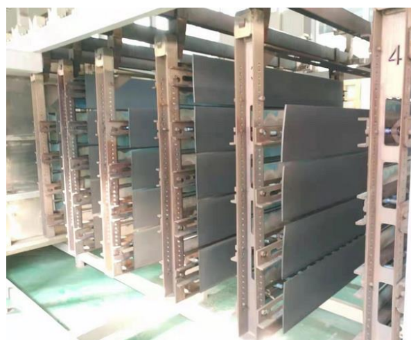
图38：铜箔生箔机的阳极板作为耗材需要定期更换
