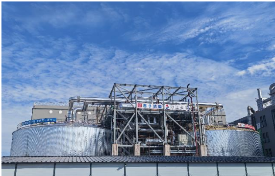
图 41: 绍兴绿电熔盐储能示范项目现场图片
