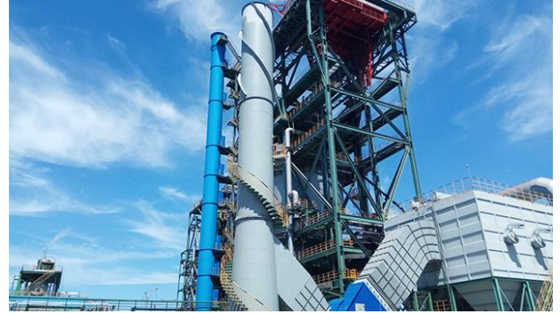
图 22: 首钢京唐 260t/h 干熄焦余热锅炉
