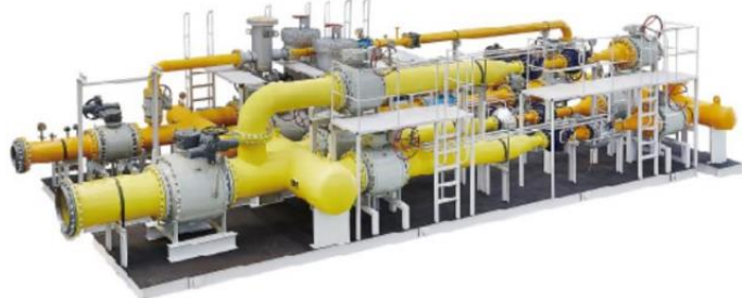
图7：大型工业用户燃气调压站负责预处理、调压等功能
