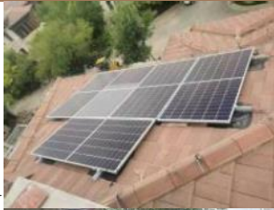
24H 智慧能源系统-光伏储能配套系统
