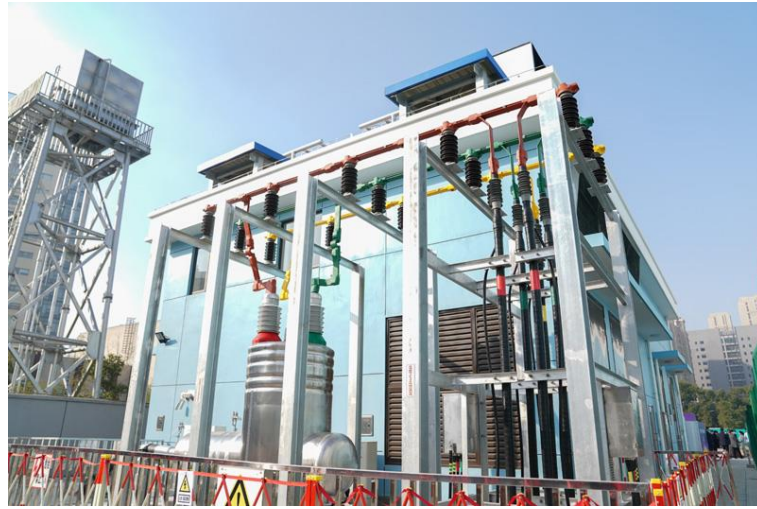
图31 我国投运世界首条 35 千伏公里级超导电缆示范工程
