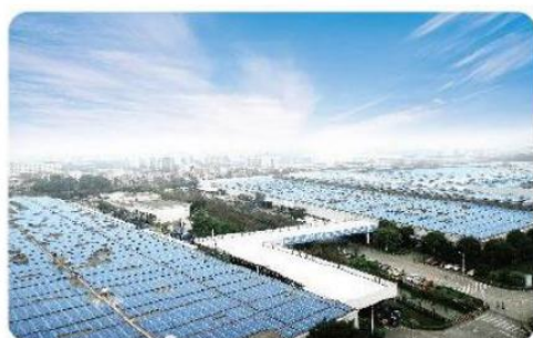
美的顺德制冷工厂分布式光伏项目
