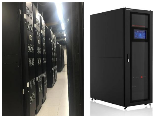
图 80: 申菱数据中心液冷机组
