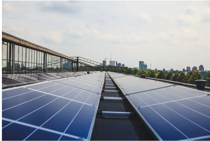
图 10: 美的威灵园区屋顶光伏发电系统
