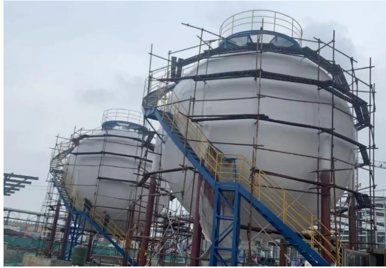
图表44：榆林华秦氢能项目400m³氢气球罐
