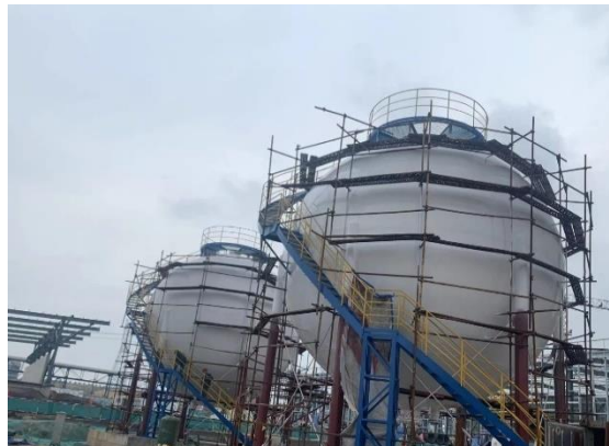
图表 120. 榆林华秦氢能项目 400m 3 氢气球罐
