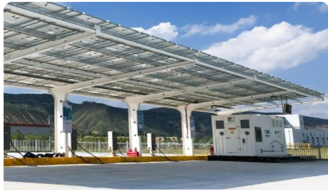
青海西宁光储充检一体化充电站
