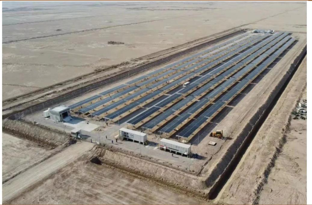
图 47：科华数能伊拉克离网光储柴微网项目
