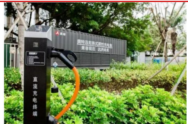
图 29：集约式柔性公共充电站
