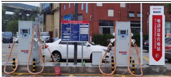
图表 41. 双杰电气北京怀柔开放环岛充电站
