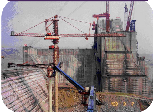
布料机及供料线系统
