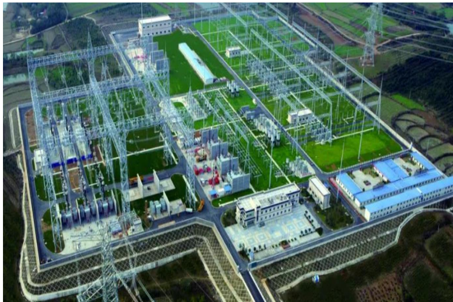
图32：1000kV晋东南—南阳—荆门特高压交流工程
