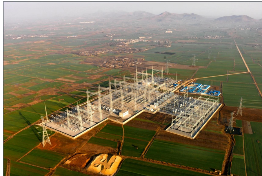
图33：向家坝—上海±800千伏特高压直流输电工程
