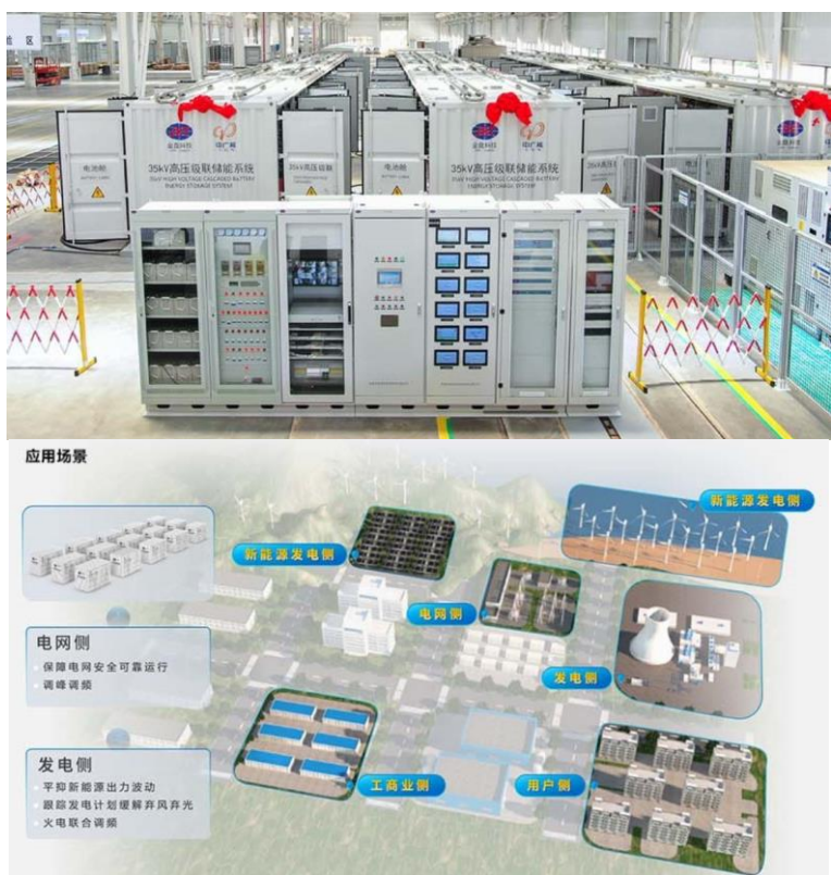
图表 48 公司 6~35kV 中高压级联直挂式储能系统及应用场景
