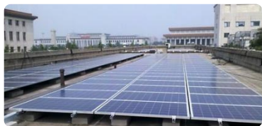
人民大会堂屋顶光伏项目
