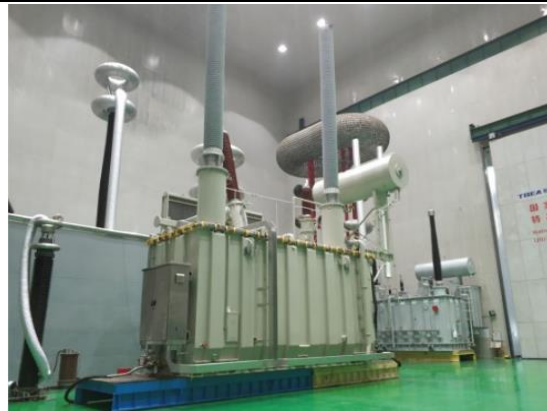
图8：张北±500kV 柔性直流输电工程的换流变压器
