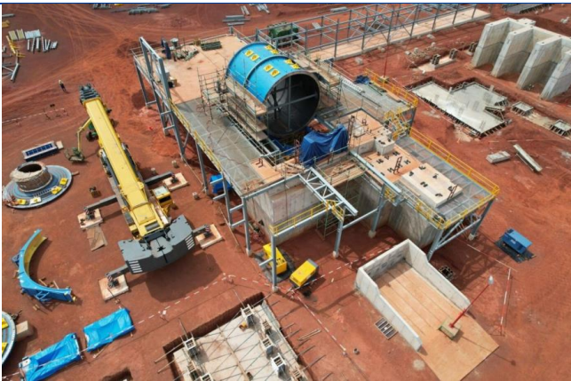
图 44: Goulamina 项目球磨机现场
