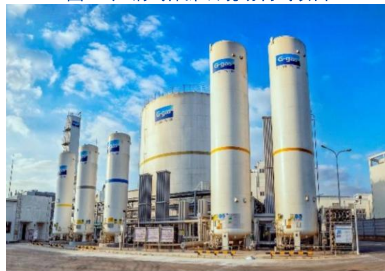
图3：广钢气体深圳现场制气项目
