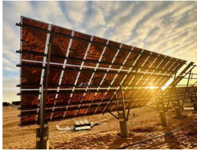
图31 内蒙古兆瓦级钙钛矿地面光伏项目
