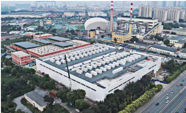
图 96：大连液流电池储能调峰电站全景
