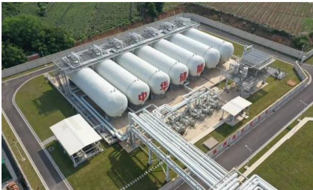
图 100：金坛盐穴压缩空气储能电站
