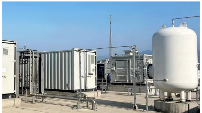
图 106：长江电力绿电绿氢项目使用阳光电源 PEM 电解技术
