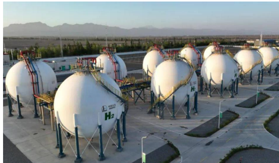
中石化库车绿氢项目配套储氢罐（下游用于炼化）
