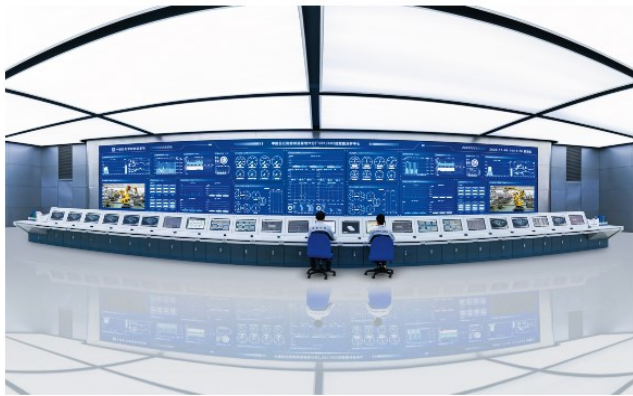
图29：中国巨石玻璃纤维智能化中控室
