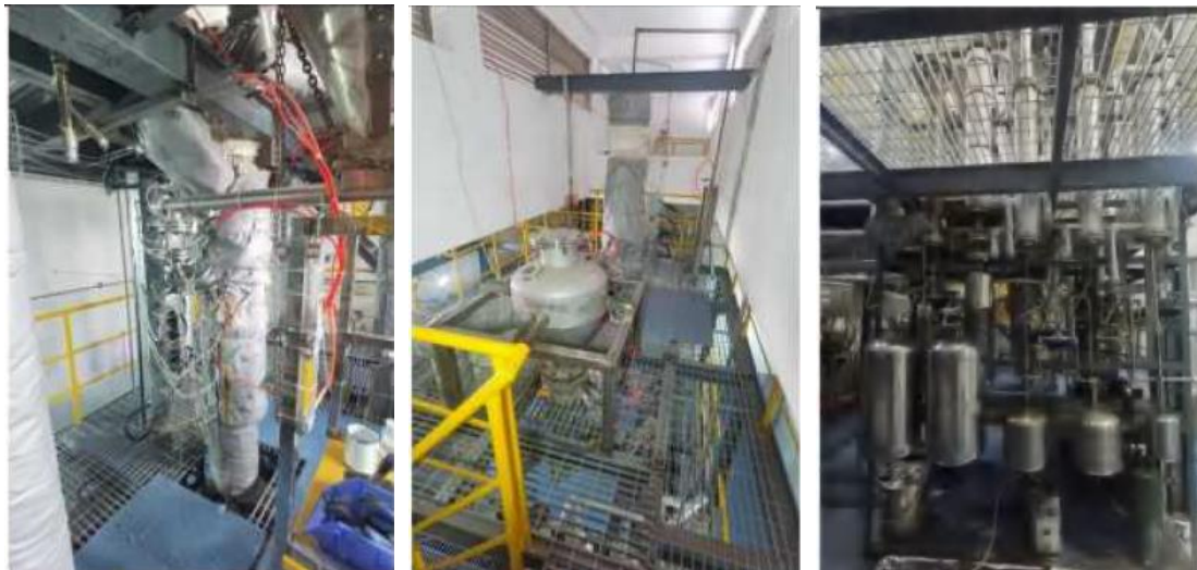
从左向右：反应器、再生器、除氯/冷凝收集设备
