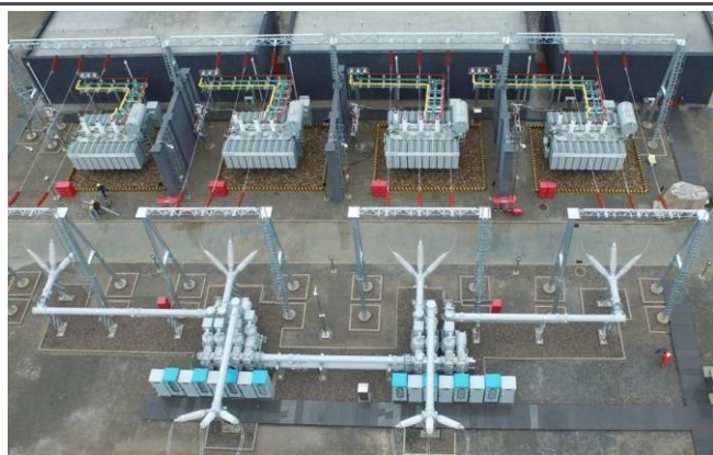
图30: 自建国际信息港 110 千伏用户变电站整体图
