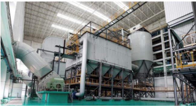
图 18: 垃圾焚烧烟气净化和灰渣处理设备
