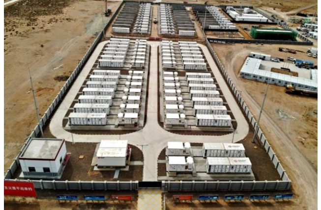
图 12：宁东复合光伏基地项目配套储能电站
