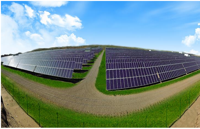
图 16: 夏宁东光伏电站亚洲最大光伏电站之一
