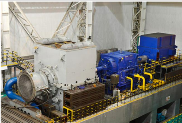
图7. 空分装置压缩机组
