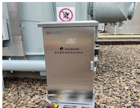
图17: 新一代变压器色谱在线监测系统
