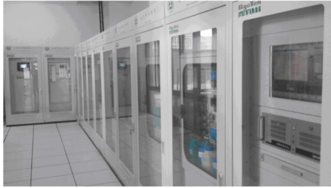
图17.公司研发的“SYSTEK-WQMS”固定式饮用水源地水质自动监测系统
