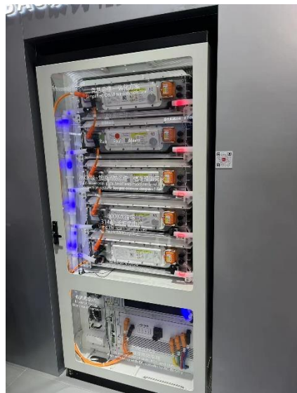
图表：固德威推出8000+循环次数工商业储能系统
