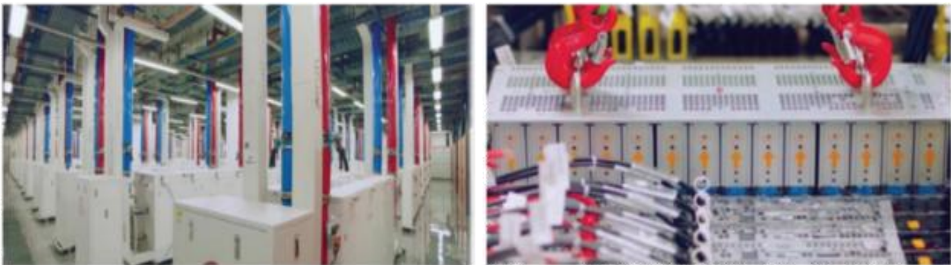
部署在数据中心的液冷 TANK
