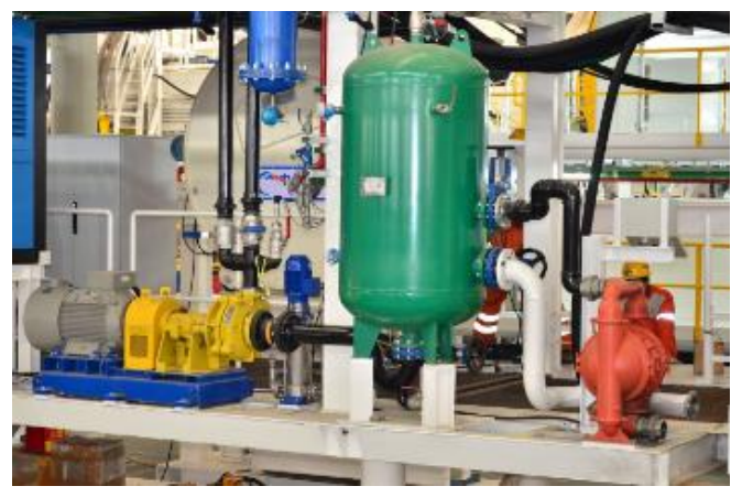
图62：中铁工业研制出泥水盾构泥浆快速回收系统
