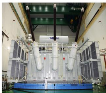
SFP-JT-1180000/500现场组装式发电机变压器
