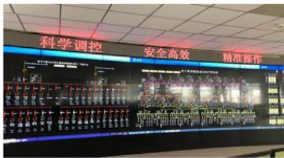
神华宁煤400万吨煤制油全厂孤岛项目
