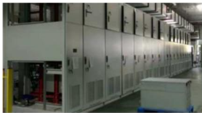
珠海“互联网+”智慧能源示范工程项目
