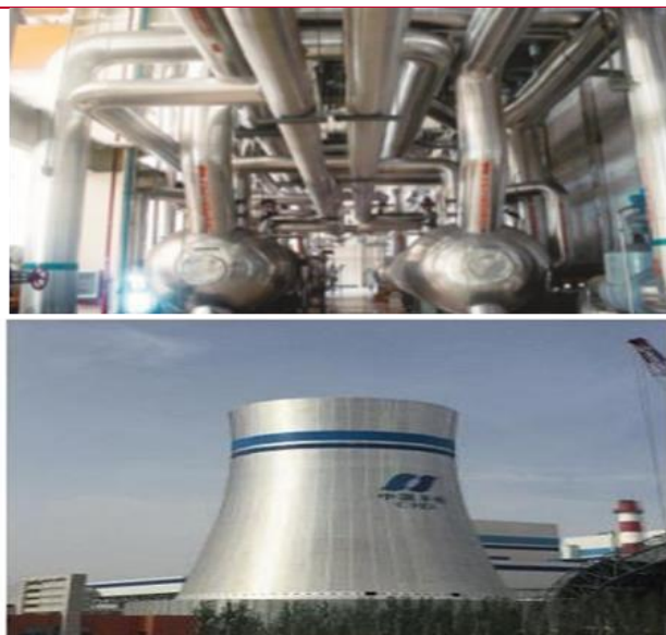
图表34：电站四大管道系统/钢结构冷却塔
