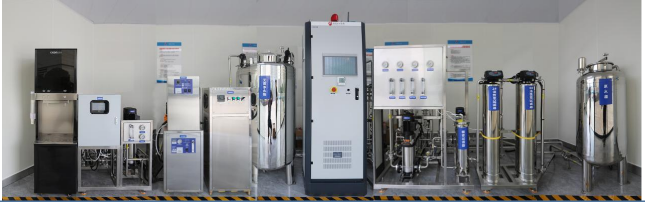
图 26: 洪城环境管道直饮水集中净化处理机房
