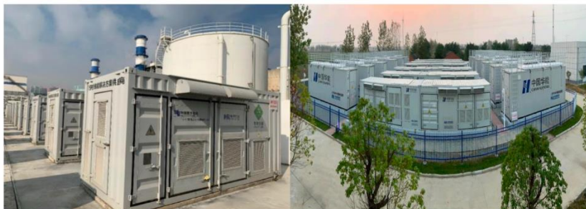
(储能工程项目现场图)
