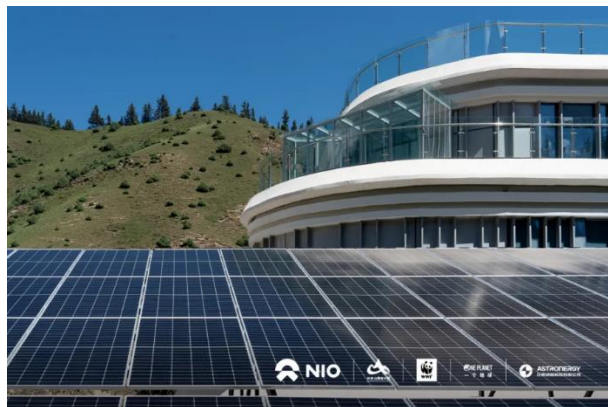
图21 蔚来 V2G 光伏自循环场站
