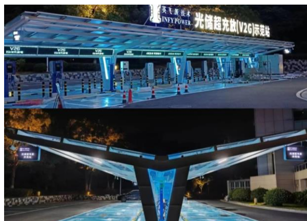
图20 英飞源投建南京首个光储超充放示范项目
