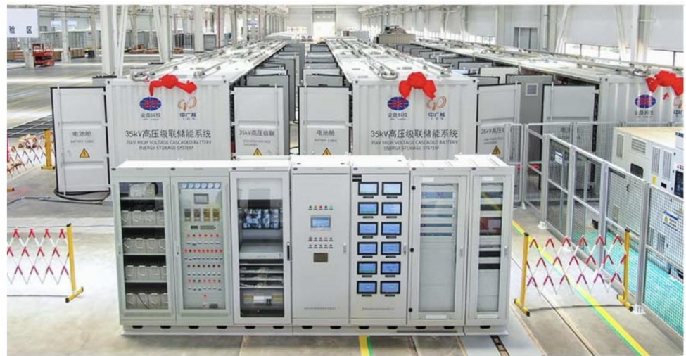
图28.35kV 高压直挂级联储能系统
